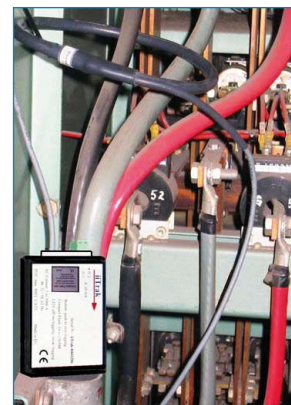
Měřicí smyčka instalovaná v elektrorozvaděči
